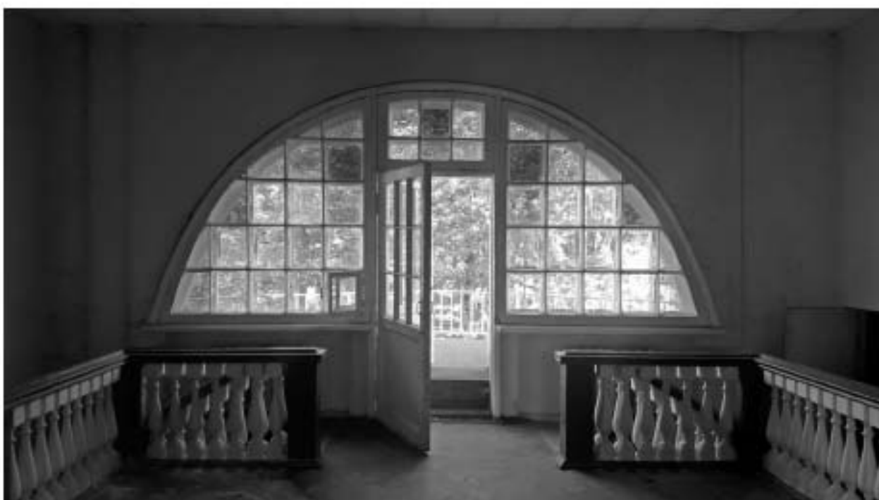
49. «Загородный дом Ф.Р. Витцеля» по адресу: Санкт-Петербург, г. Сестрорецк, Парковая ул., дом 14, литера А. 2 этаж. Помещение №13 (33,0) Вестибюль. Дата съемки: 01.08.2017 г.
