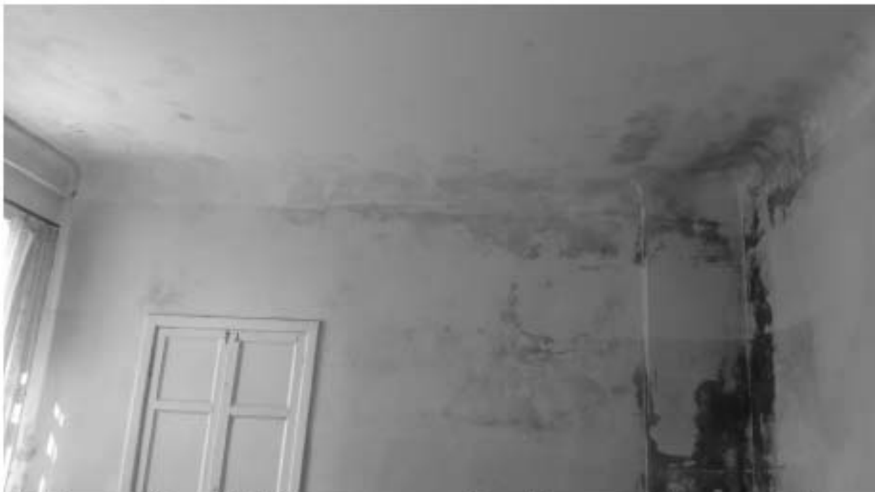
54. «Загородный дом Ф.Р. Витцеля» по адресу: Санкт-Петербург, г. Сестрорецк, Парковая ул., дом 14, литера А. 2 этаж. Помещение №21 (43,3). Дата съемки: 01.08.2017 г.
