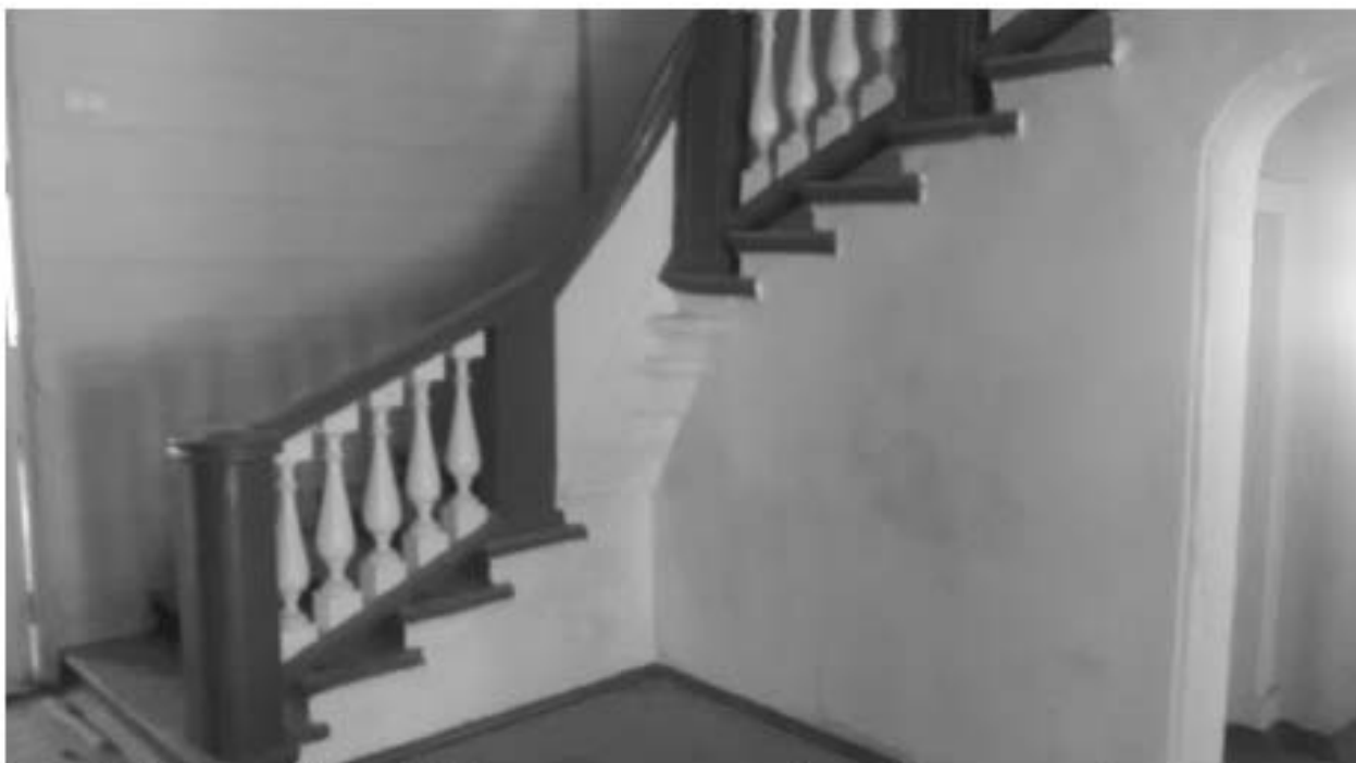
6. «Загородный дом Ф.Р. Витцеля» по адресу: Санкт-Петербург, г. Сестрорецк, Парковая ул., дом 14, литера А. 1 этаж. Помещение №1 (35,4) Вестибюль. Дата съемки: 01.08.2017 г.
