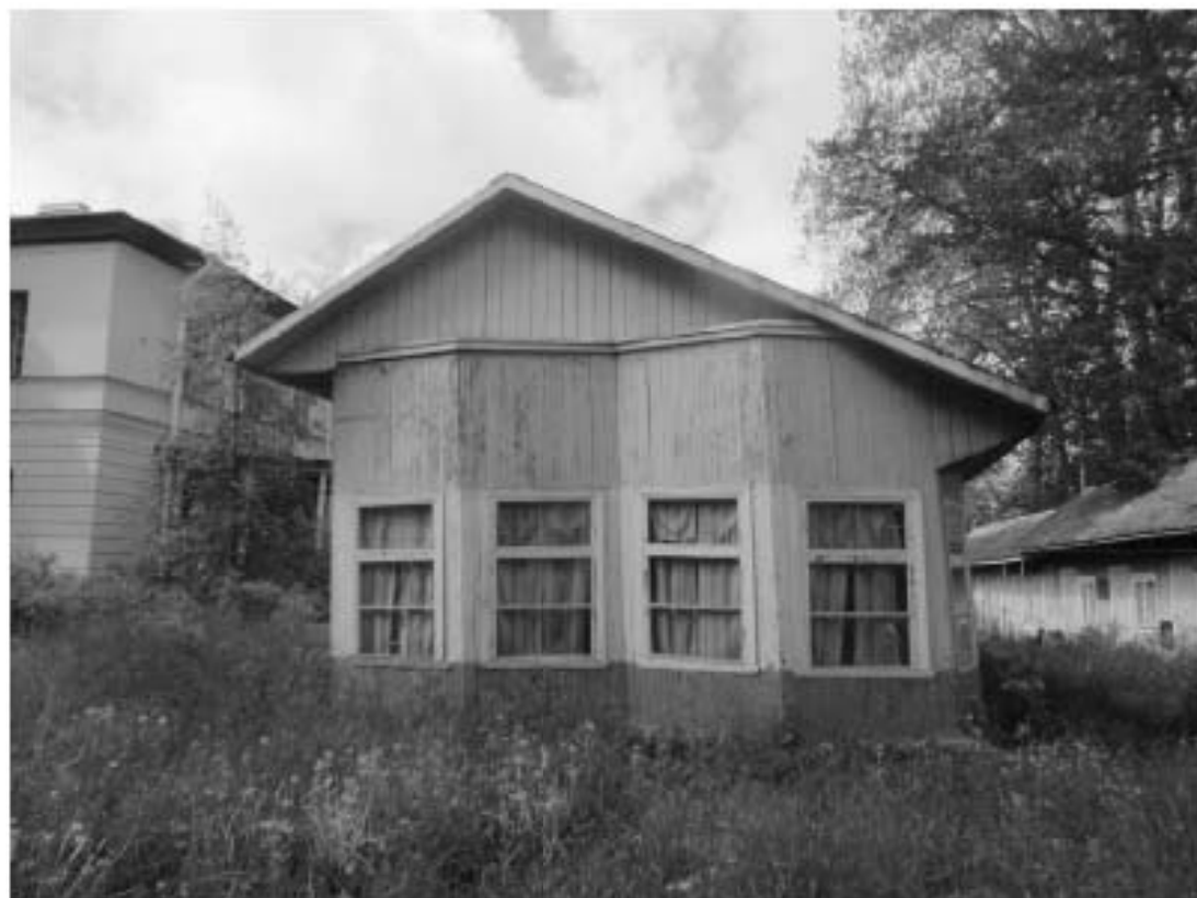
3. Северная часть территории ОКН «Загородный дом Ф.Р. Витцеля». Здание по адресу: Санкт-Петербург, г. Сестрорецк, Парковая ул., д. 14, литера П. Восточный фасад. Дата съемки: 01.08.2017 г.
