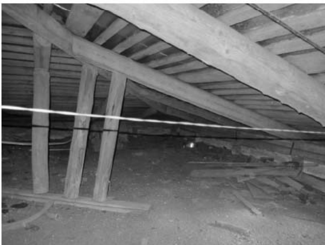
89. «Загородный дом Ф.Р. Витцеля» по адресу: Санкт-Петербург, г. Сестрорецк, Парковая ул., дом 14, литера А. Чердак. Дата съемки: 01.08.2017 г.
