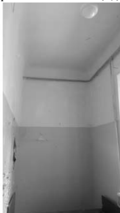
65. «Загородный дом Ф.Р. Витцеля» по адресу: Санкт-Петербург, г. Сестрорецк, Парковая ул., дом 14, литера А. 2 этаж. Помещение №25 (11,7). Дата съемки: 01.08.2017 г.
