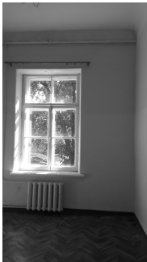
58. «Загородный дом Ф.Р. Витцеля» по адресу: Санкт-Петербург, г. Сестрорецк, Парковая ул., дом 14, литера А. 2 этаж. Помещение №19 (14,0). Дата съемки: 01.08.2017 г.
