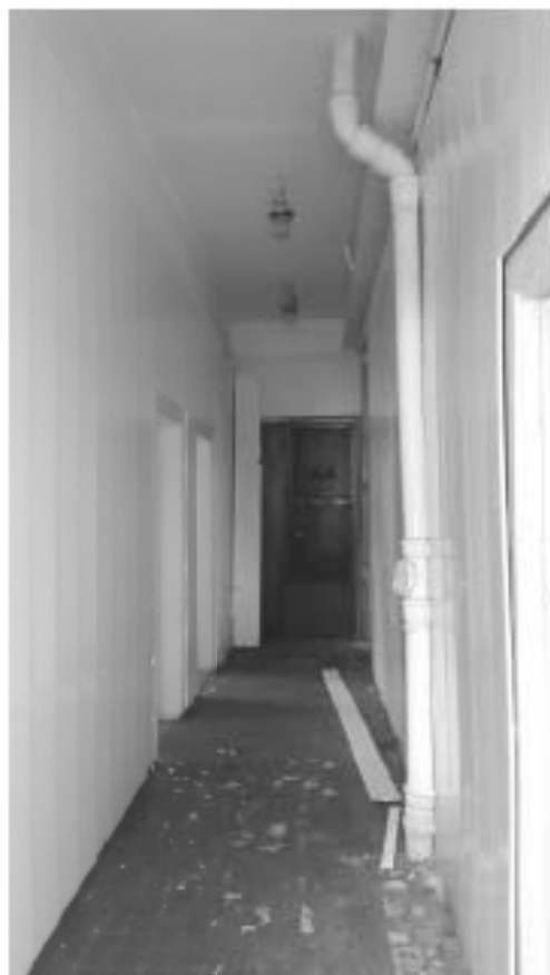
73. «Загородный дом Ф.Р. Витцеля» по адресу: Санкт-Петербург, г. Сестрорецк, Парковая ул., дом 14, литера А. Одноэтажная пристройка. Помещение №1 (12,7). Коридор. Дата съемки: 01.08.2017 г.
