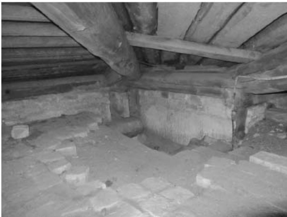
88. «Загородный дом Ф.Р. Витцеля» по адресу: Санкт-Петербург, г. Сестрорецк, Парковая ул., дом 14, литера А. Чердак. Дата съемки: 01.08.2017 г.
