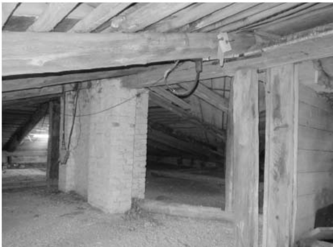
90. «Загородный дом Ф.Р. Витцеля» по адресу: Санкт-Петербург, г. Сестрорецк, Парковая ул., дом 14, литера А. Чердак. Дата съемки: 01.08.2017 г.
