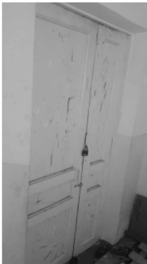
39. «Загородный дом Ф.Р. Витцеля» по адресу: Санкт-Петербург, г. Сестрорецк, Парковая ул., дом 14, литера А. 1 этаж. Помещение №12 (5,0). Дата съемки: 01.08.2017 г.
