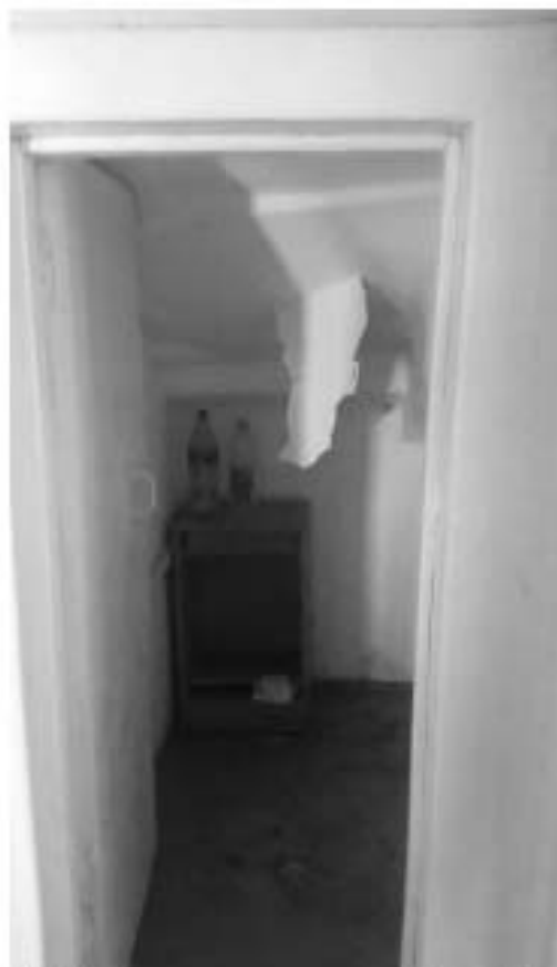
22. «Загородный дом Ф.Р. Витцеля» по адресу: Санкт-Петербург, г. Сестрорецк, Парковая ул., дом 14, литера А. 1 этаж. Помещение №33 (0,4) Кладовая. Дата съемки: 01.08.2017 г.
