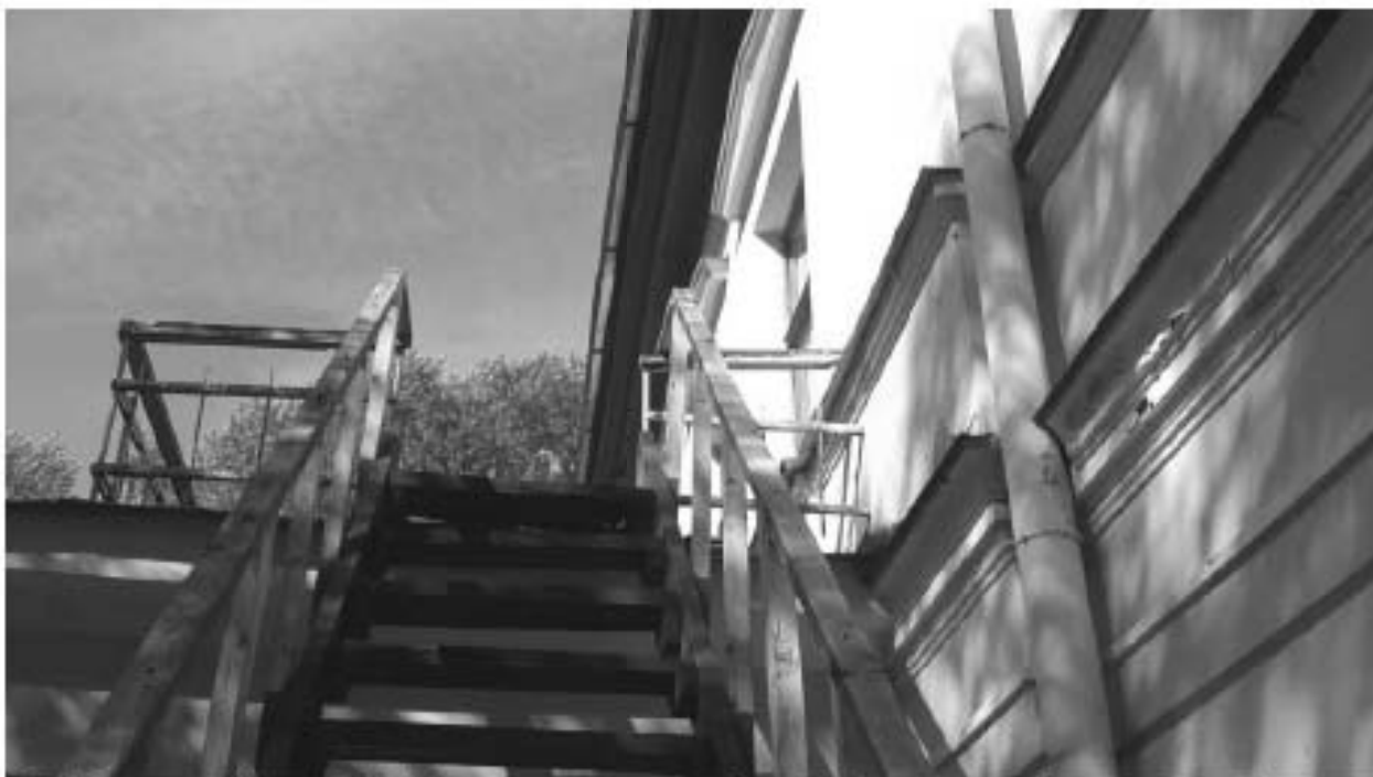
19. «Загородный дом Ф.Р. Витцеля» по адресу: Санкт-Петербург, г. Сестрорецк, Парковая ул., д. 14, литера А. Приставная деревянная лестница на открытый балкон. Дата съемки: 01.08.2017 г.
